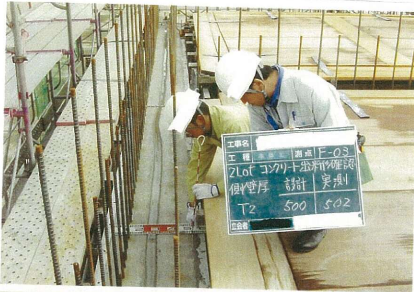
コンクリート打設 翌日の表面状態
